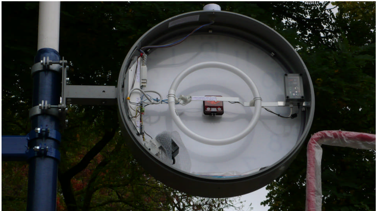
De klok, met schemerschakelaar, wordt aangestuurd door een SR290DH impulsgever (rechts).
