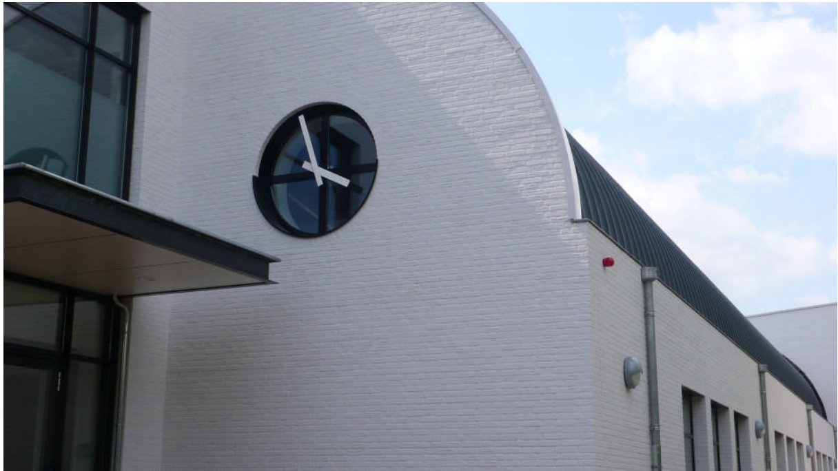
HSV1 torenuurwerk, gemonteerd in raam bij ingang MFA gebouw te Luyksgestel. Montage: Burgmans & Alewijns Elektrotechniek C.V. te Bergeijk.
